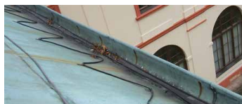
topný kabel instalovaný v nástřešním žlabu a na okraji střechy
